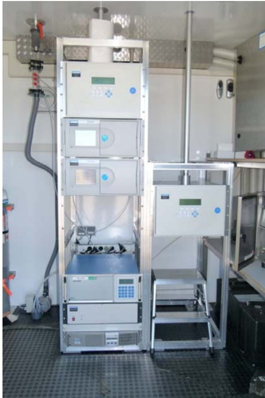
Abbildung 5. Innenausstattung der mobilen Luftgütemessstation.
